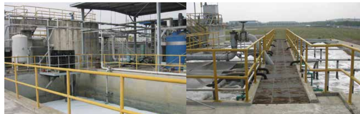
Hệ thống xử lý nước thải tại doanh nghiệp
